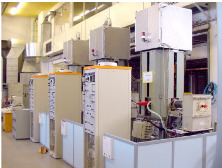
Modernisierte DESY-2- Senderanlage
